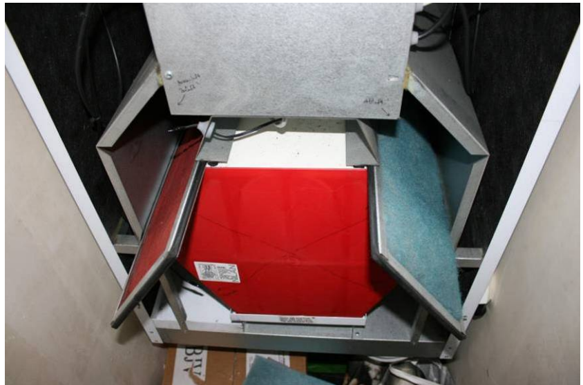
Foto Filter im Lüftungsgerät:
