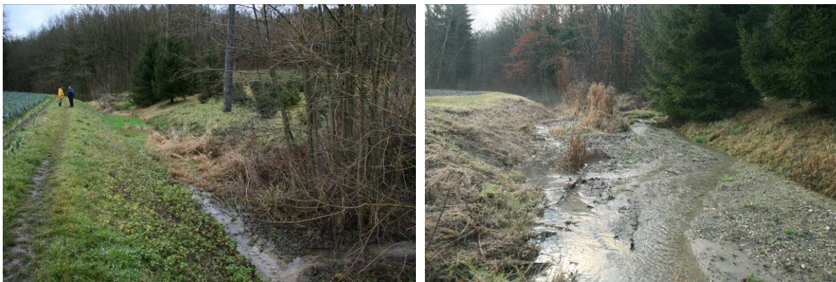
Photo 6. Les dépôts issus des matériaux érodés du coteau obligent l'eau à s'écouler vers l'amont du canal d'amenée
