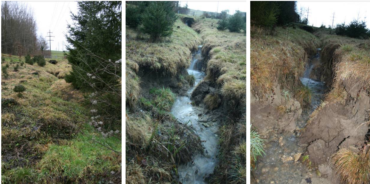
Photo 5. Ruisseau en rive droite fortement incisé, emportant les matériaux du coteau dans le canal d'amenée. Évolution observée de janvier 2007 à janvier 2008.
