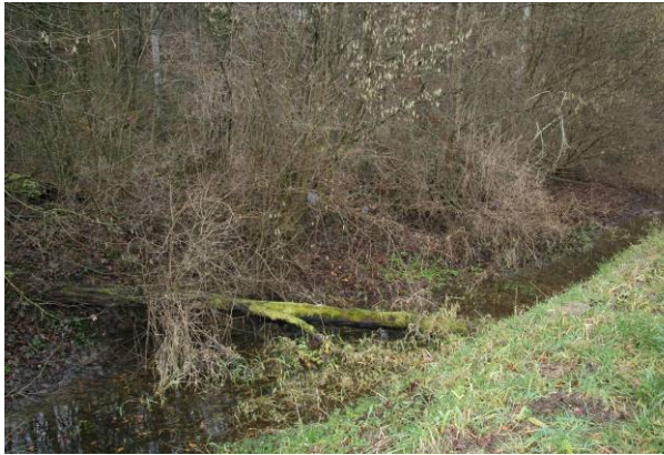
Photo 7. Canal d'amenée envahi par les végétaux
