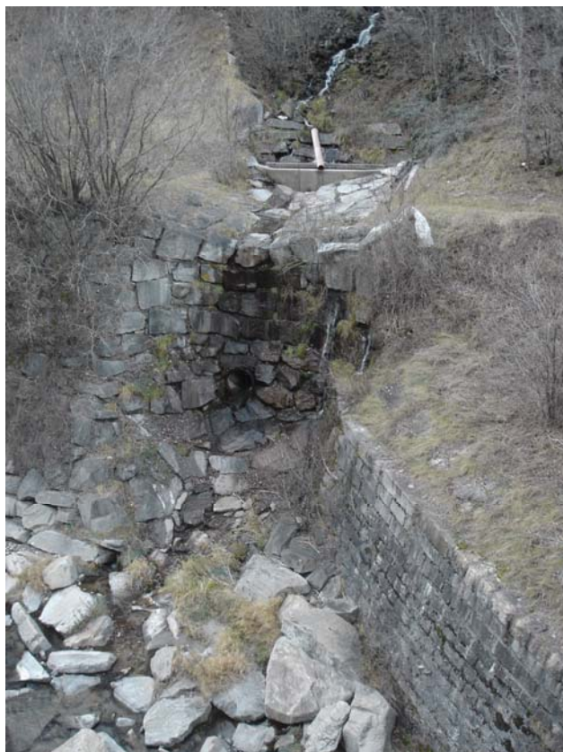
a quota 800 m.s.m. captazione Alptransit e manufatto/argine fiume Ticino
