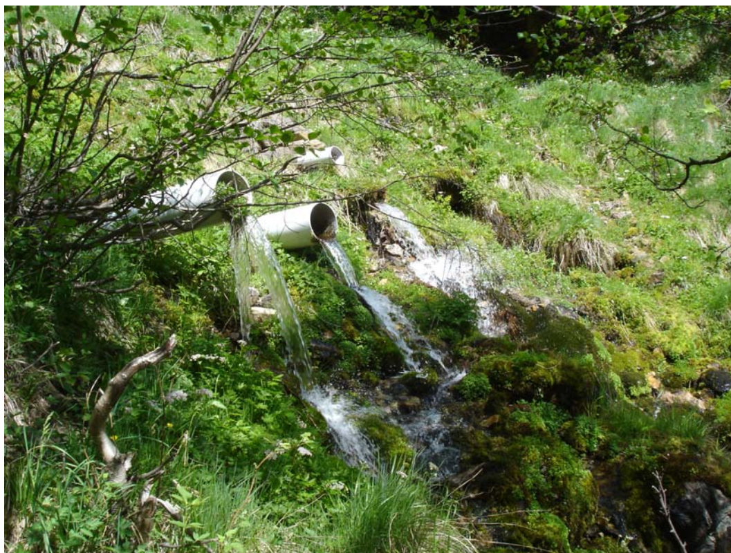
scarico sfioratori sorgenti Fiöud ~1'515 m.s.m.
