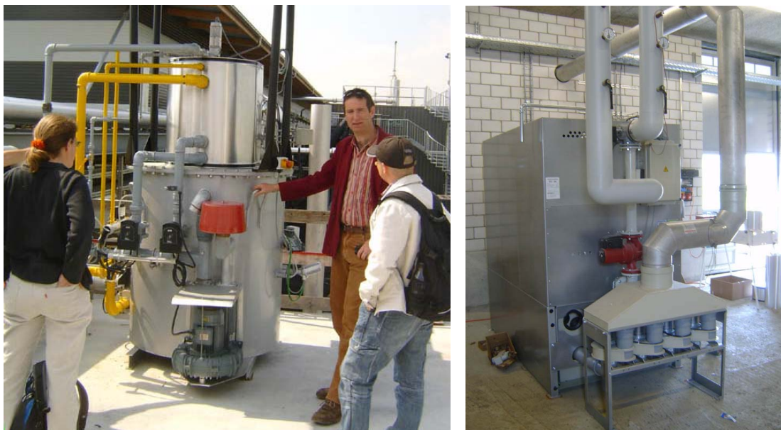
Abbildung 14 Begehung der Biogasanlage „Swiss Farmer Power“ in Inwil mit Sandra Hermle und Bruno Guggisberg. Links die Schwachgasverbrennungsanlage auf dem Dach und rechts die kondensierende Kesselanlage im darunter befindlichen Kesselhaus.
