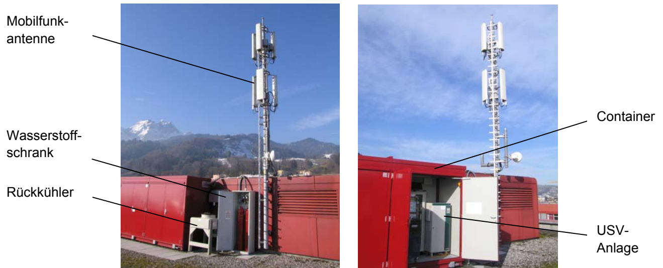
Abbildung 4: Aufstellung vor Ort mit Mobilfunkantenne
