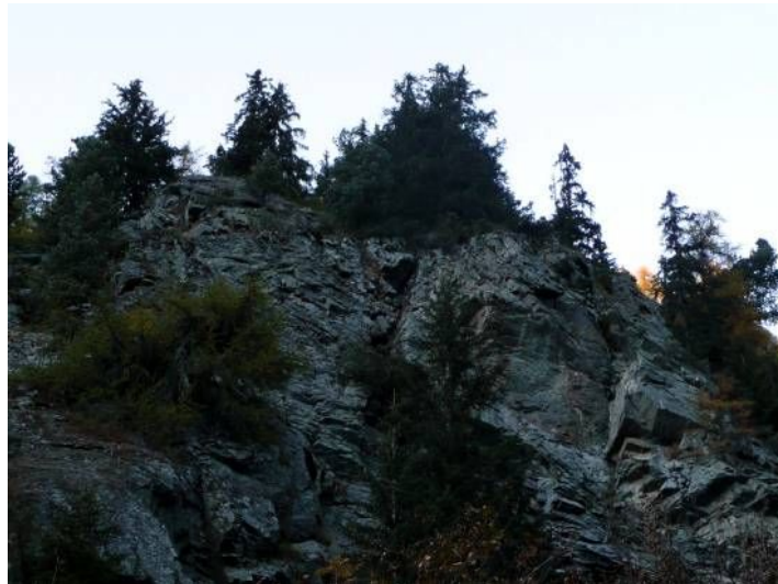
Photo 0.1 : Falaise et présence de compartiments potentiellement instables
