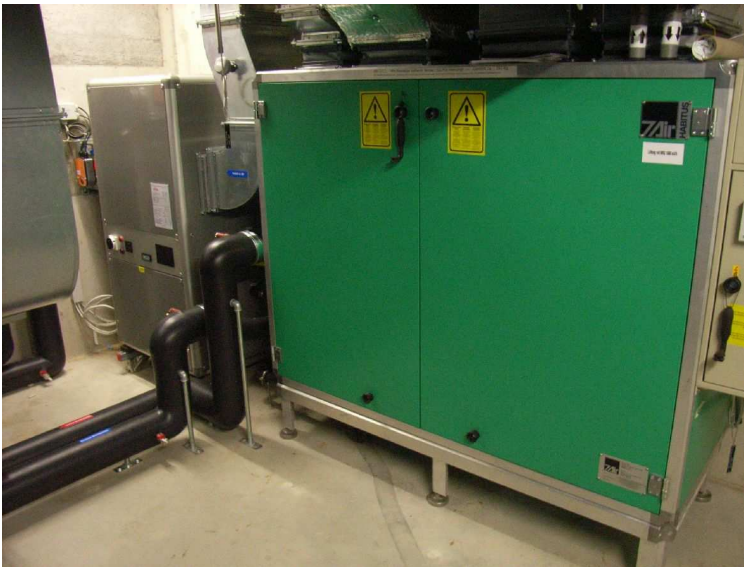
Abbildung 3-11: zentrales Lüftungsgerät mit Gegenstromwärmetauscher und Fortluftwärmepumpe
