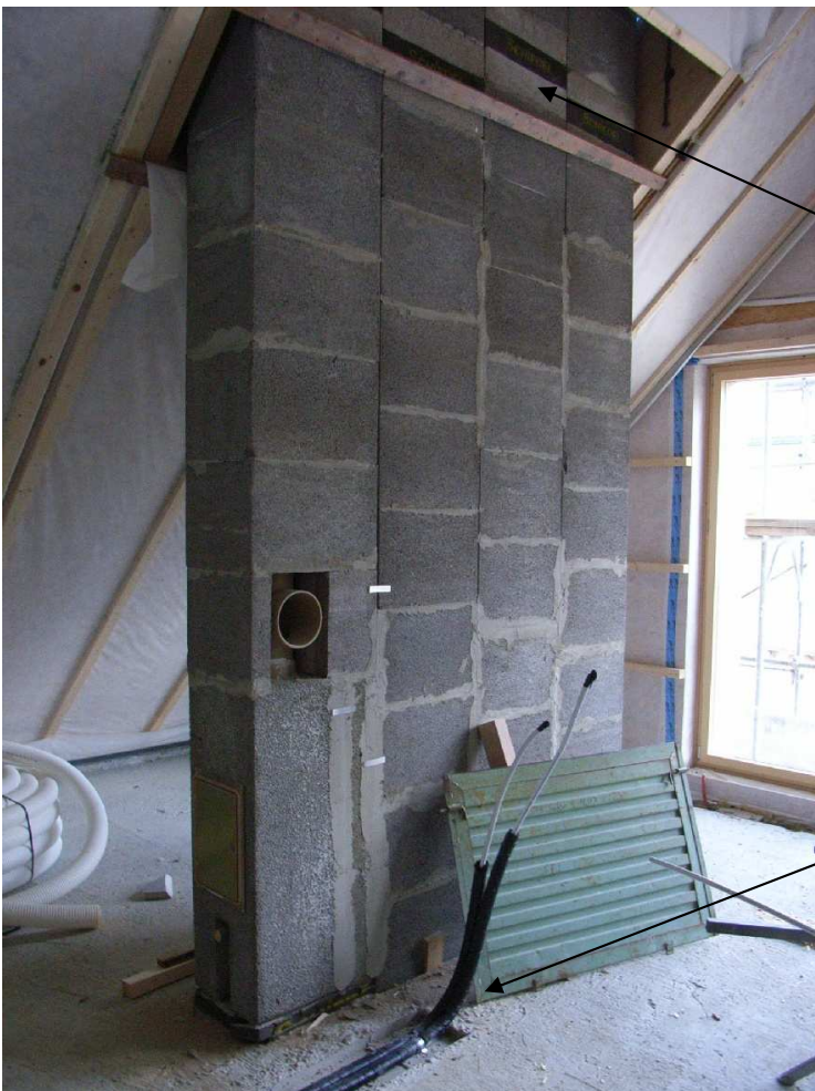
Abbildung 3-12: Kaminanlage im DG
