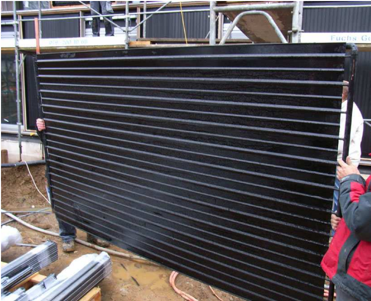
Abbildung 3-4: Absorberforderseite der Fassadenkollektoren
