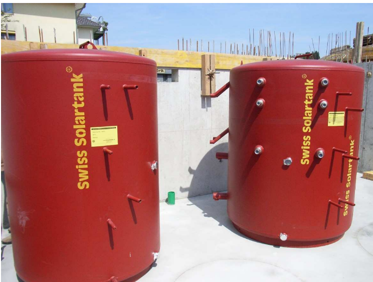
Abbildung 3-7: Die beiden Warmwasserspeicher mit Integralboiler
