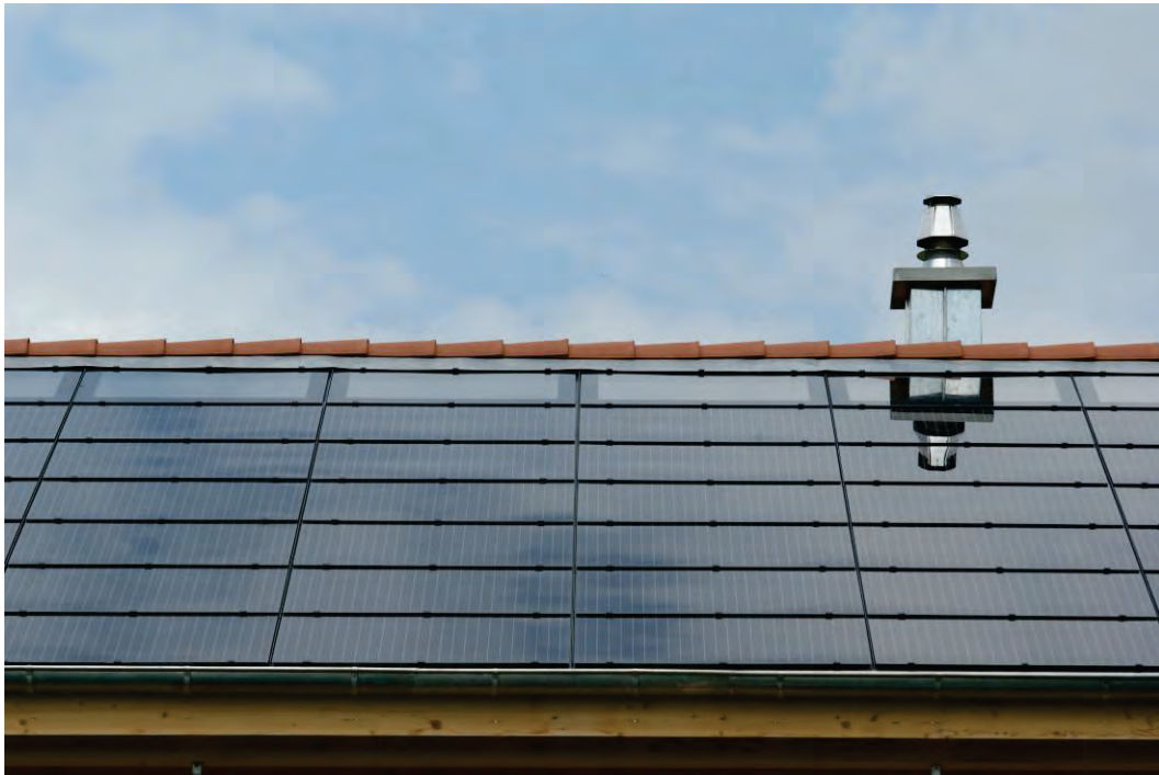
ABBILDUNG 11 AUSSCHNITT MIT THERMIEPANELEN
