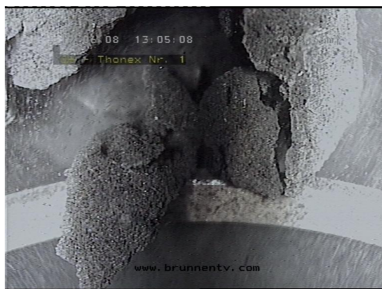
Ecaillage de l'encroûtement
