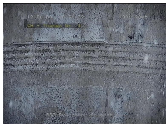
Tubage visible avec joint
