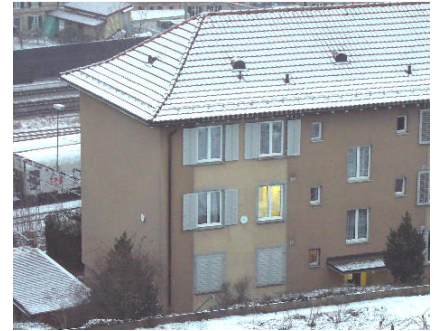
Fig. 3: Mustergebäude. Helle Stellen = ohne Wärmedämmung.
