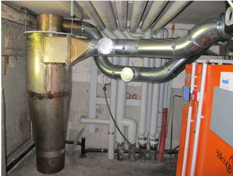
Abb. 14: Zwischen Wäscher und Feuerung zwischengeschalteter Zyklon (links im Bild), der Ascheteile grösser 2 \mu\text{m} abscheidet. In den Rohren sind die Messstutzen für die Abgasmessungen sichtbar.
