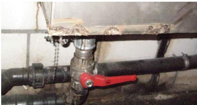
Abb. 13: Korrosionsschäden durch Chlor führten innerhalb weniger Wochen zu Leckagen am Wäscher.
