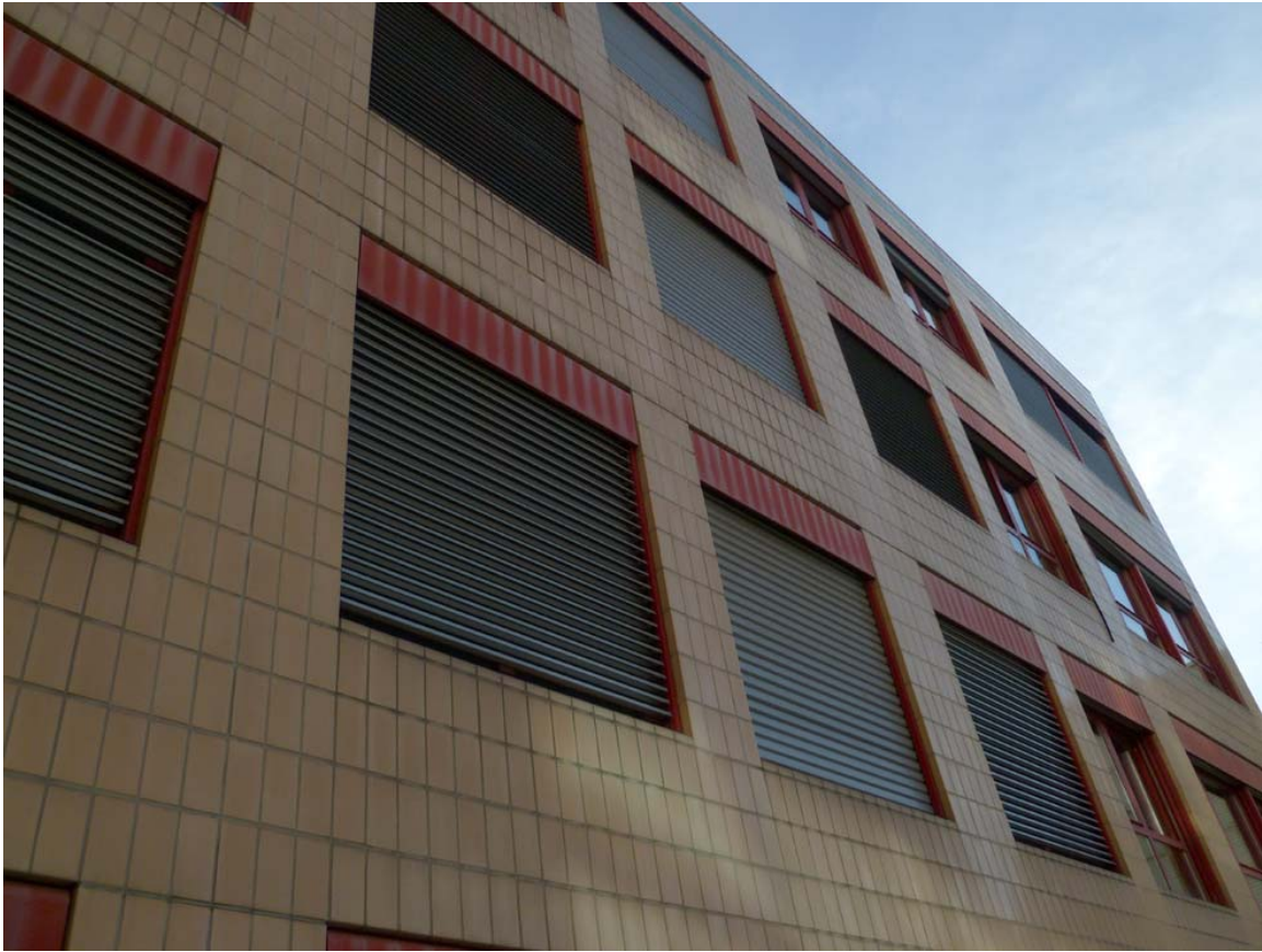
Fig. 4 : Autre typologie de façade mesurée à hepia bâtiment B, façade orientée SUD - SUD - OUEST
