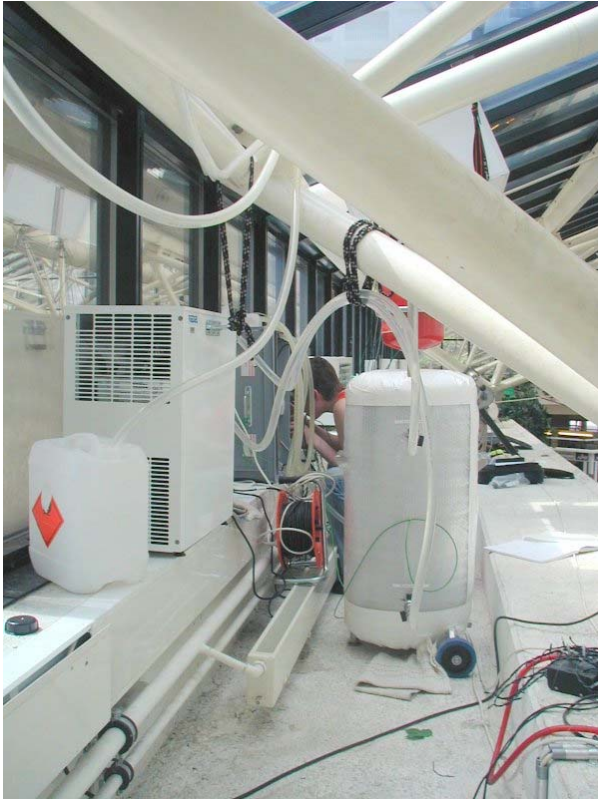
Figure 7: groupe froid et réservoir tampon (isolé)
