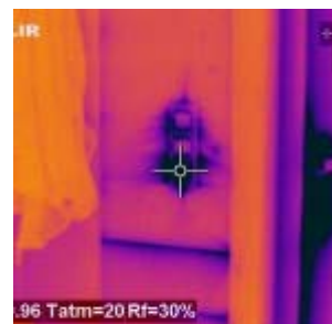
Abbildung 9: Wärmeverlust über Steckdose (Quelle: Bauherrenhilfe.at)
