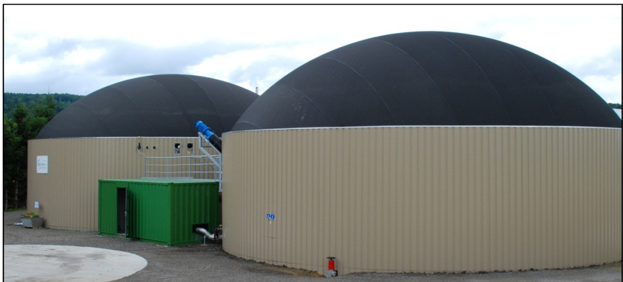
Abbildung 1: Biogasanlage mit EPDM-Einfachmembran als Gasspeicherhaube
