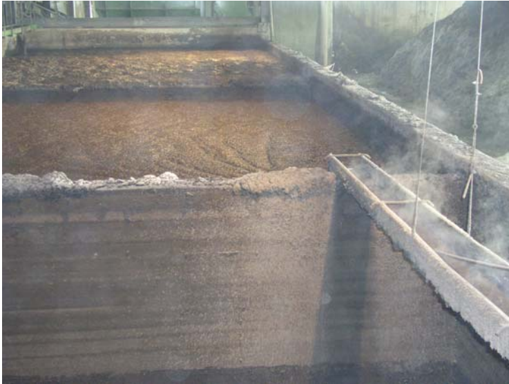
Abb. 1: Presswasser-Auslaufrinne (rechts) und Absetzbecken der Anlage in Klingnau.
