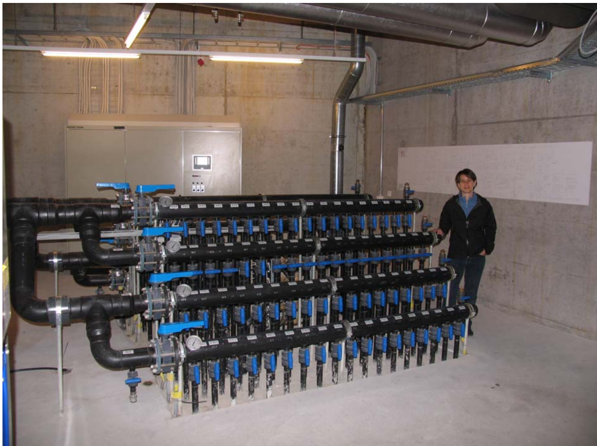
Figur 17: Verteiler des Geothermiespeichers im Keller des Hotels "The Dolder Grand" mit insgesamt 70 Erdwärmesonden.
