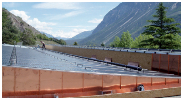
Figure 11 : La toiture solaire du centre sportif alimente le complexe en eau chaude sanitaire et chauffe en partie les bassins. (photo : Energie Solaire SA)
