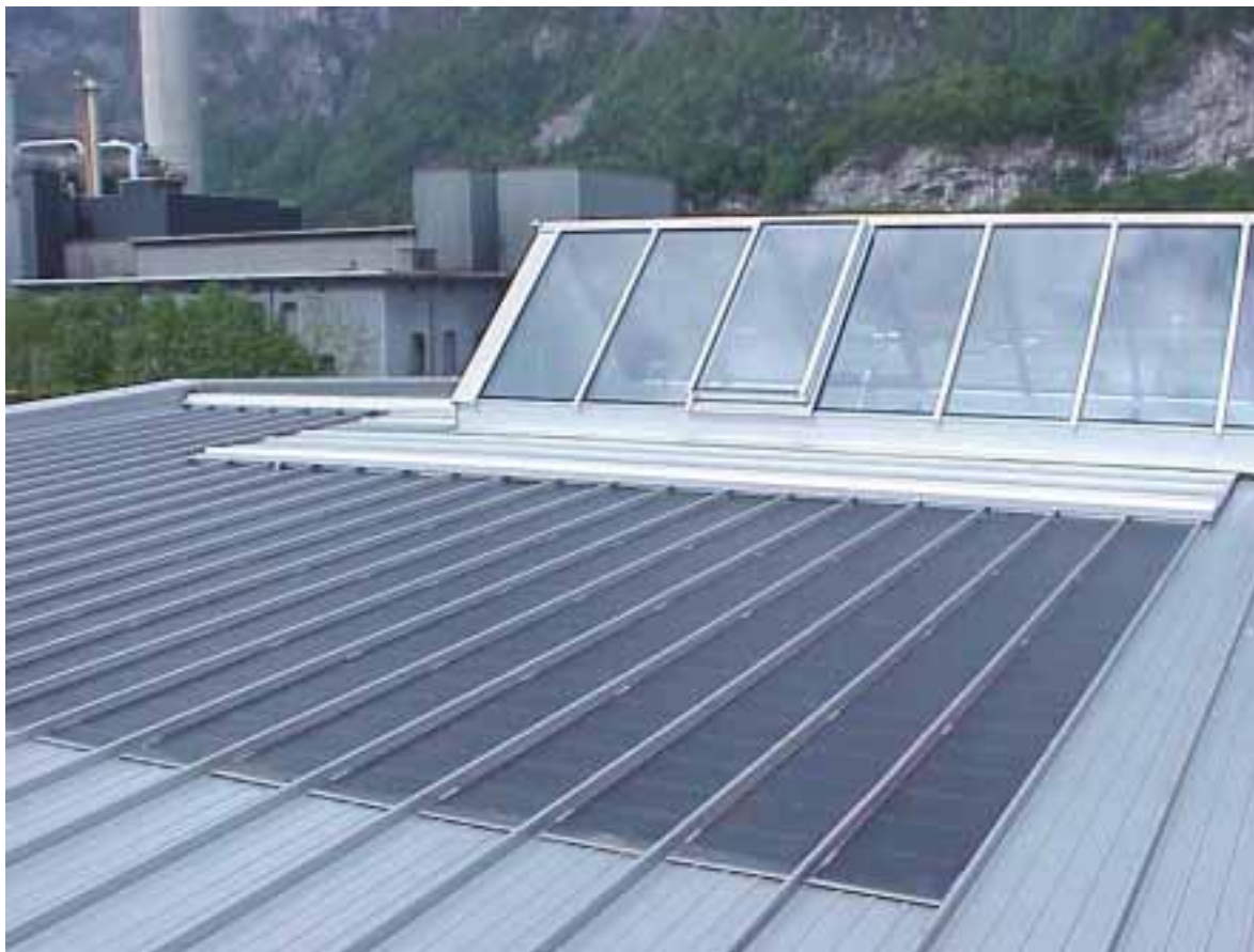
Bild 1: Gesamtansicht Pilotanlage EURODACH solar
