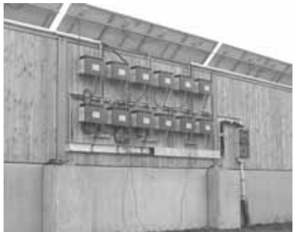
Bild 06 Ansicht auf die Wechselrichtergruppe Wand West und darüber verlaufendem Kabelkanal. Stand der Arbeit am 10. Nov. 2000.
