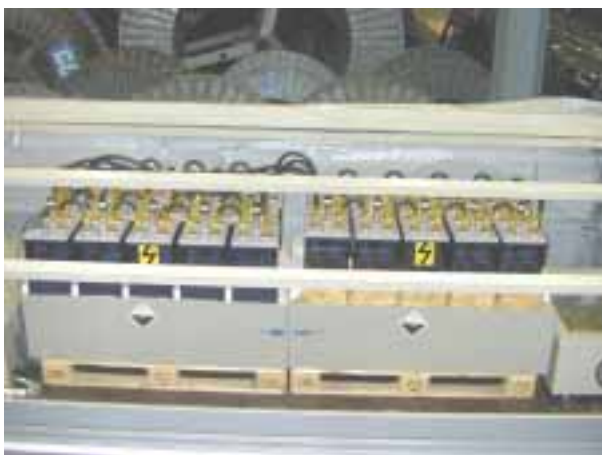
Stock de batteries (vue de face)
