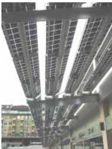
Photo 5: Installation 'Riponne': vue sous les modules
