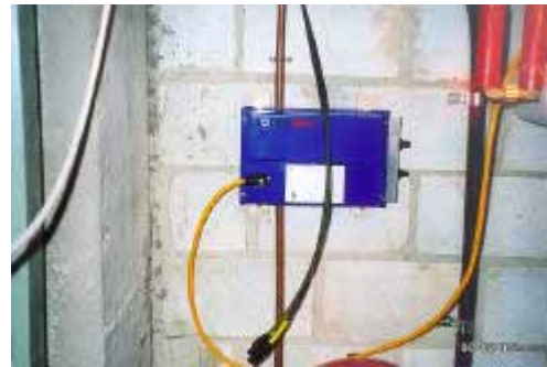
Bild 3: Solcolino mit DC Zuleitung (nicht angeschlossen) und AC-Kabel
