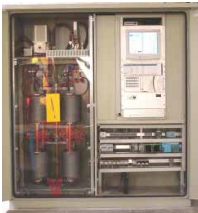
Photo 2: Couplage au réseau DC et système de monitoring
