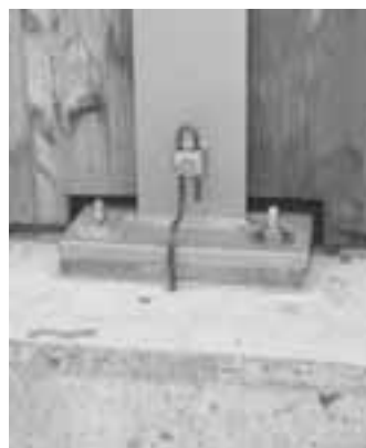
Bild 08 > Blitzschutzverbindung unten von Stützen auf Fundament- armierung.
