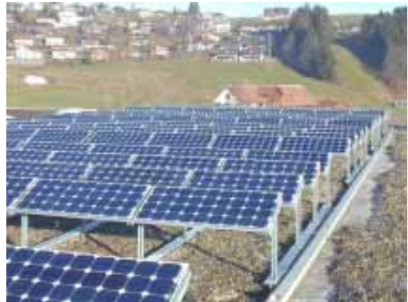
Bild 19: Anlage Einsiedeln von vorne
