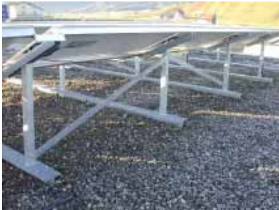
Bild 18: Anlage Einsiedeln von hinten
