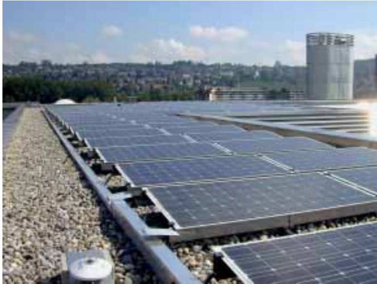
Bild 10: 47 kWp Anlage IBM Zürich, Foto: NET AG
