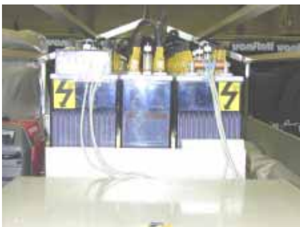
Stock de batteries (vue de profil)
