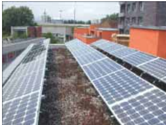
Bild 6: Solgreen Kraftwerk 1, Zürich (Bildquelle: Enecolo AG)
