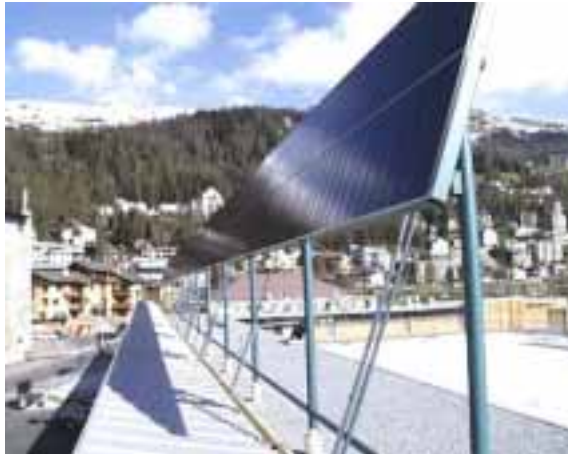
Bild 7: Anlage in St. Moritz mit CIS Modulen (Bildquelle: TISO)
