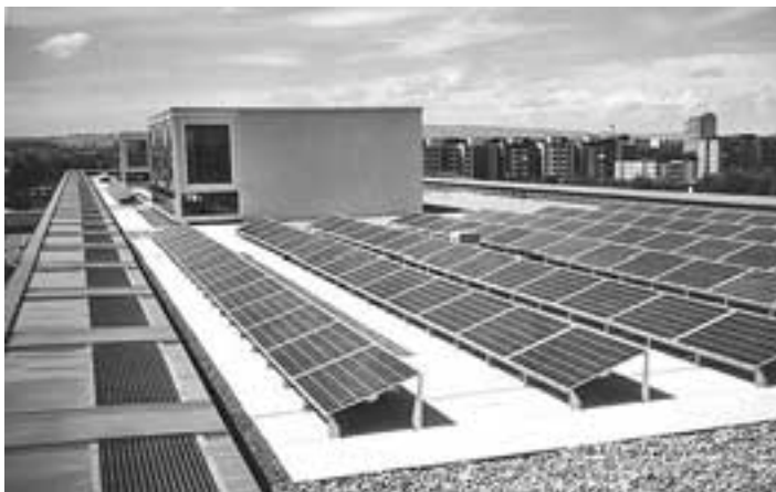
Bild 8. Fotoaufnahme des ersten SOLight-ähnlichen Anlage auf dem Dach des KV Zug.
