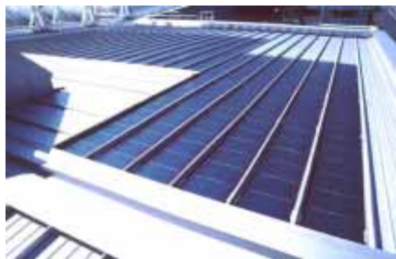
Bild 10: PV Eurodach amorph Flumroc (Bildquelle: NET AG)
