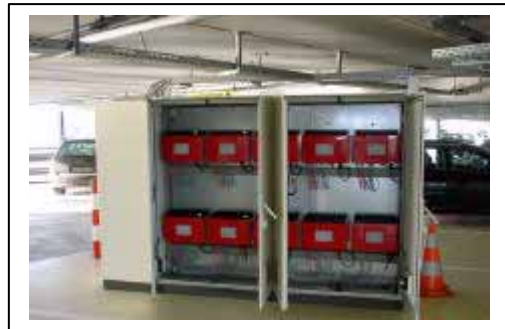
Armoire onduleur sud
