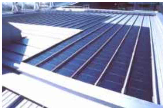
Bild 15: PV Eurodach amorph Flumroc (Bildquelle: NET AG)
