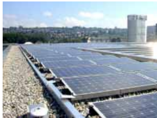
Bild 21: Flachdachanlage IBM Zürich (Bildquelle: NET AG)
