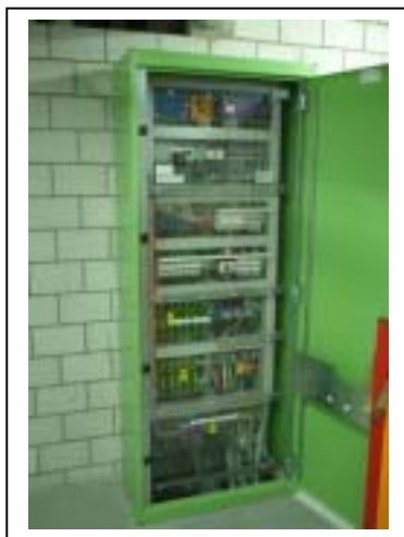
Photo 8 Armoire de disjoncteurs et de monitoring
