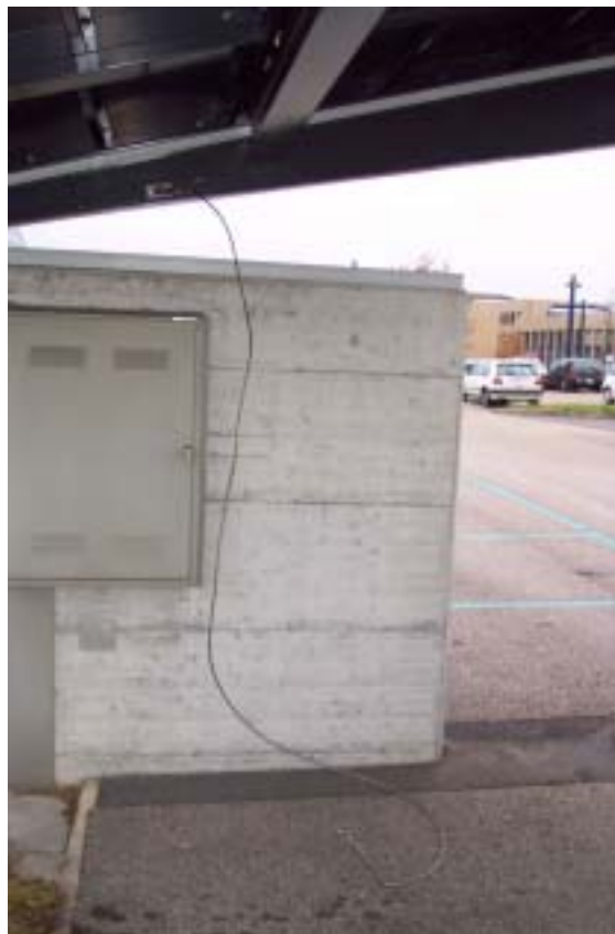
Fig. 3: Le câble de contreventement éclaté
