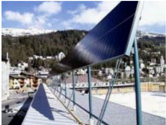
Bild 16: 16,8 kWp Anlage mit CIS Zellen St. Moritz (Bildquelle: LEEE-TISO)
