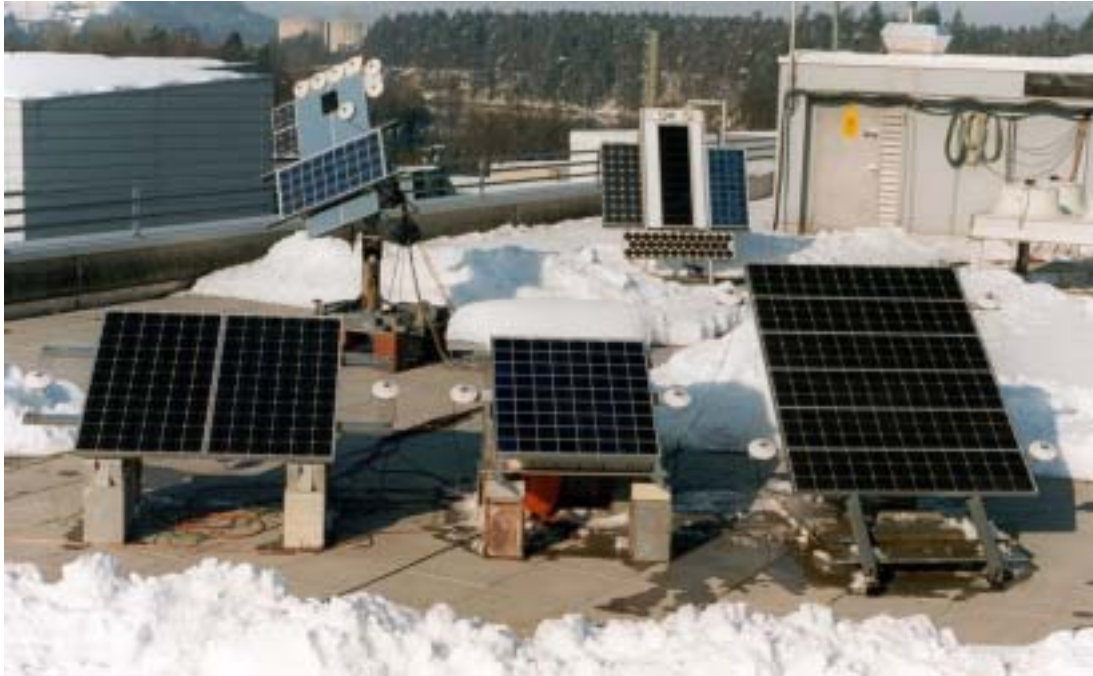
Abb. 2: Photovoltaik-Testanlage des PSI. Hinter den drei Netzverbundanlagen im Vordergrund befindet sich links eine Sonnennachführ-Vorrichtung. Darauf werden die Testmodule montiert. Oben auf der Vorrichtung befinden sich Pyranometer zur genauen Messung der Einstrahlung, welche auf die Testmodule einfällt.
