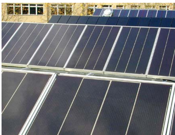
Bild 17: 3x1 kWp Testanlagen Newtech Burgdorf (Bildquelle: NET AG)
