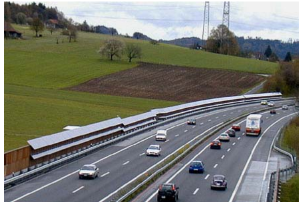
Bild 20: 75 kWp Schallschutz Anlage A1 Safenwil (Bildquelle: BFE )
