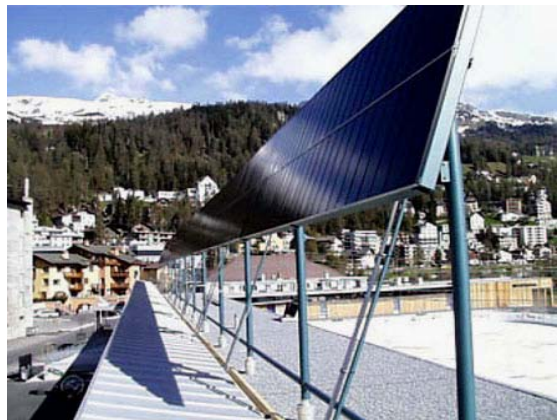
Bild 16: 16,8 kWp Anlage mit CIS Zellen St. Moritz (Bildquelle: LEE-TISO)
