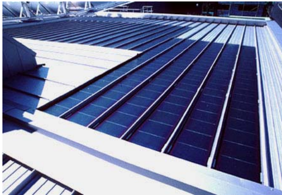
Bild 19: 3 kWp PV Eurodach amorph Flums (Bildquelle: NET AG)
