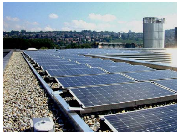
Bild 23: Flachdachanlage IBM Zürich (Bildquelle: NET AG)
