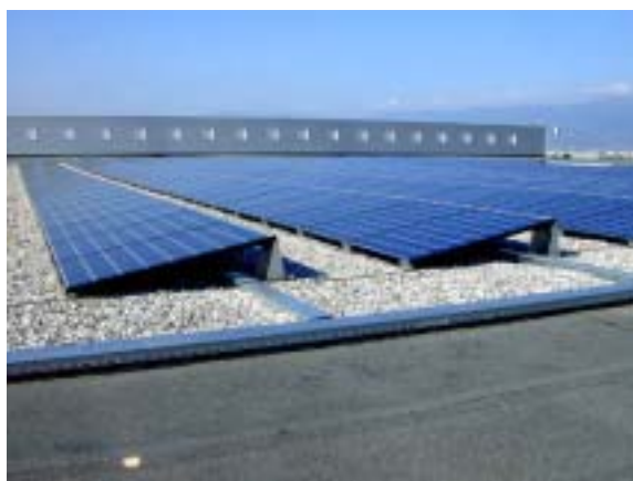
Figur 24: 70 kWp Flachdachanlage Palexpo Genf (Bildquelle NET)
