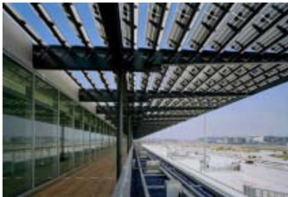
Figur 16: PV-Beschattungsanlage Dock Midfield (Bildquelle unique / Ralph Bensberg)
