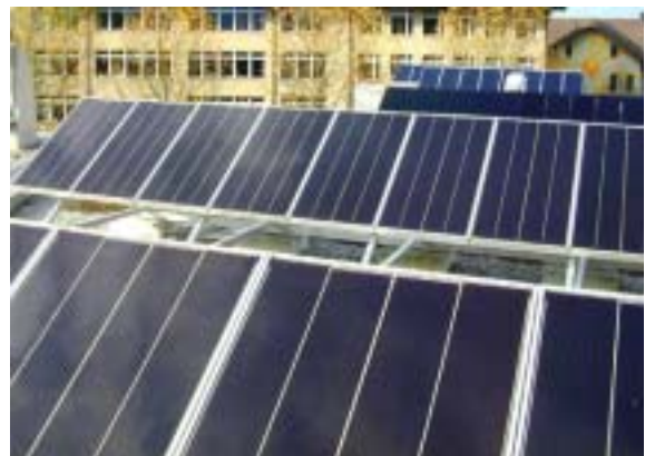
Figur 37: 3x1 kWp Testanlagen Newtech Burgdorf (Bildquelle NET)
