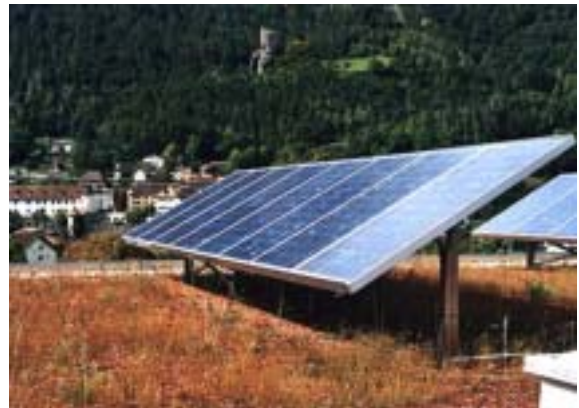
Figur 33: 10 kWp Gründachanlage Solgreen Chur (Bildquelle NET)
