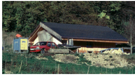
Figur 26: Autonome 3 kWp Dachintegration Soyhières (Bildquelle NET)
