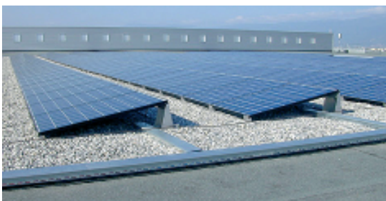
Figur 25: 70 kWp Flachdachanlage Palexpo (Bildquelle NET)
