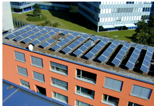
Figur 9: Solgreen Kraftwerk 1 (Bildquelle: NET)
