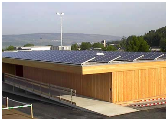
Figur 5: 27 kWp Anlage Alustand Hünenberg (Bildquelle Urs Bühler Energy Systems)
