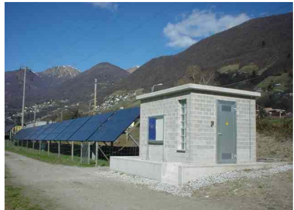
Figur 13: Messkampagne zur 100 kWp Anlage AET III (Bildquelle: TISO)
