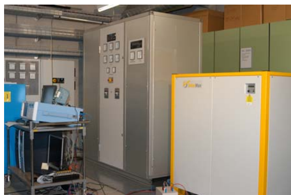
Figure 6: Générateur simulateur solaire de 100 kW avec un onduleur Sputnik de 100 kW (Source: HESB-TI)
