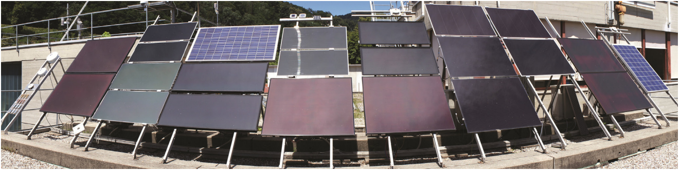
Figur 3: Outdoor Messstand mit 11 verschiedenen Dünnschicht PV-Modulen und 2 kristallinen Silizium-Modulen zur Vergleichsmessung (Bildquelle: ISAAC SUPSI).
