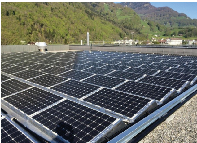
Figur 10: PVT Hybridkollektoren auf der Lintharena in Näfels (Quelle: ZHAW Wädenswil)
