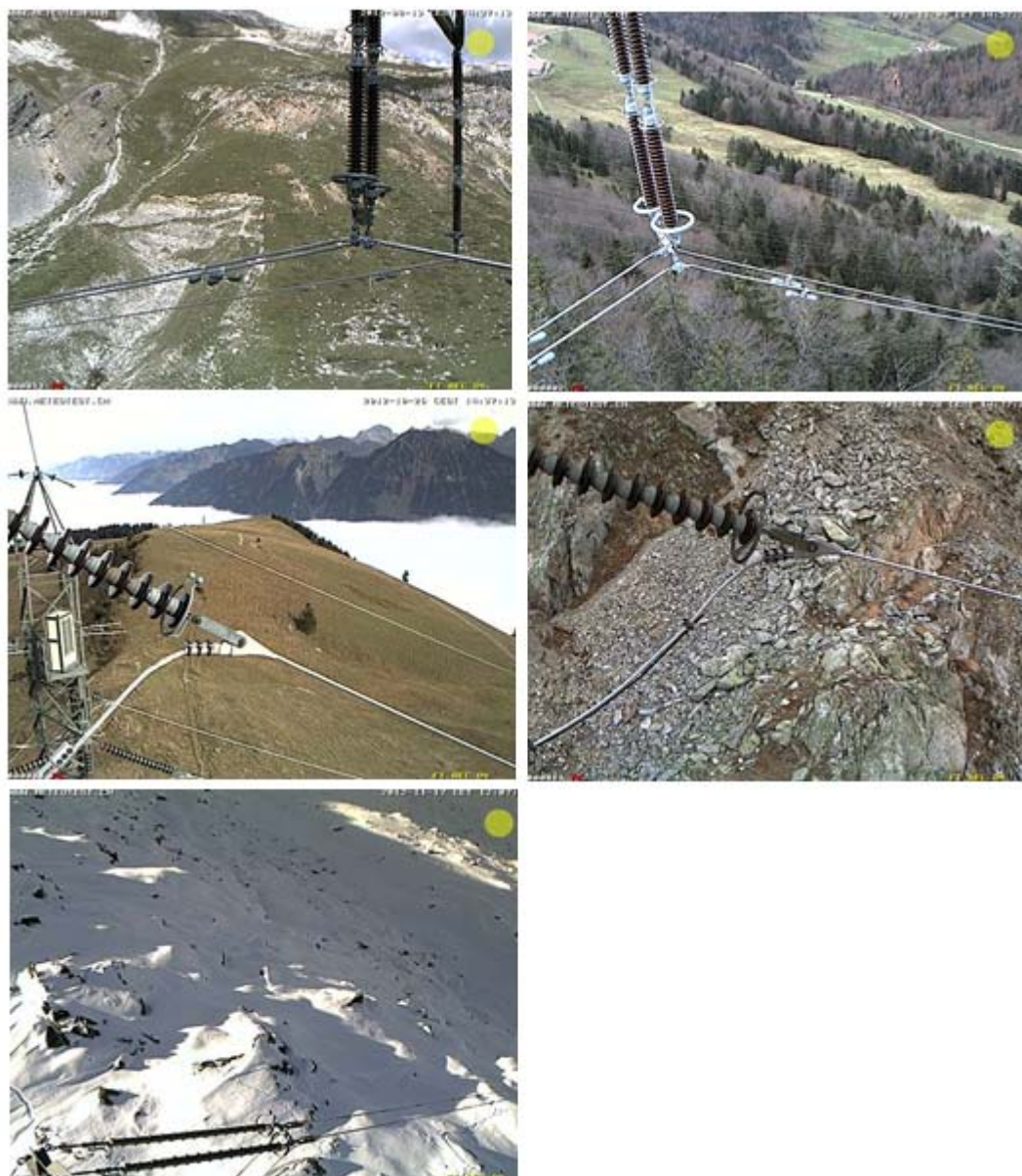
Abb. 6: Aufnahmen der Webcams von Leitungen und Isolatoren an den Standorten Lagalb (oben, links), Scheltenpass (oben, rechts), Chrinde (Mitte, links), Grimsel (Mitte, rechts) und Mittelplatte (unten).
