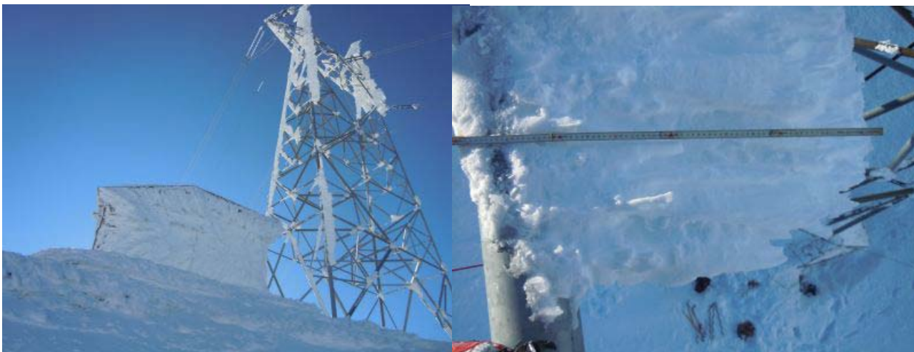
Abb. 7: Dokumentation von Eisanlagerungen an Infrastrukturanlagen der Lukmanierleitung nach dem Sturm Andrea vom Januar 2012 auf der Mittelplatte (Bilder: Alpiq Enertrans AG).
