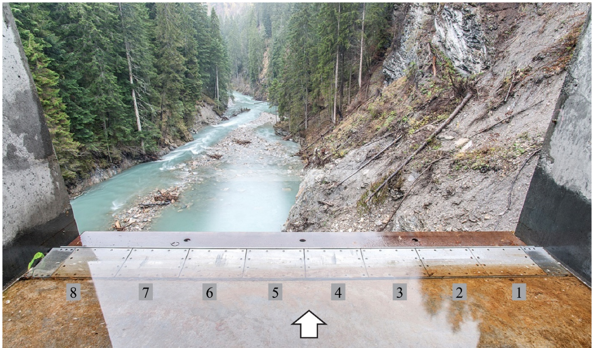
Abbildung 7: Geophon-Anlage im SBT Solis unmittelbar nach dem Einbau 2012 (VAW, ETH Zürich)
