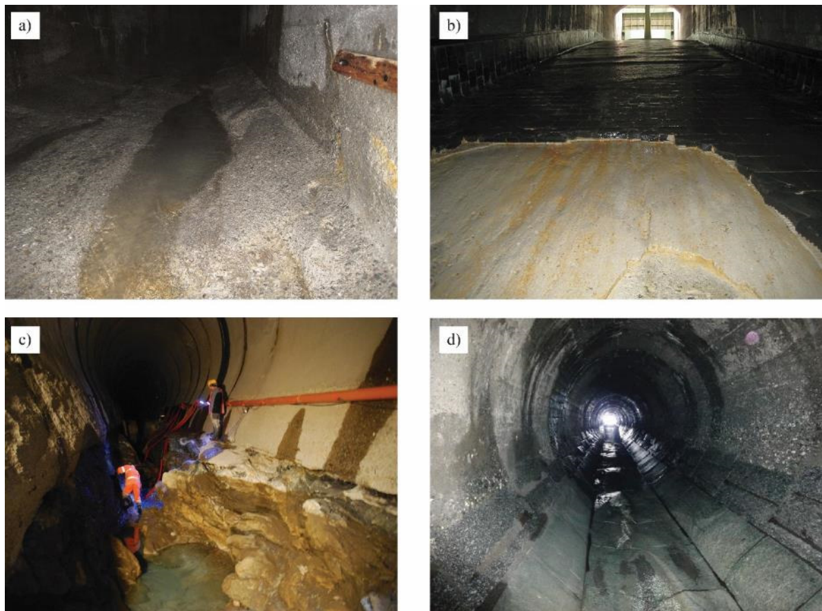
Abbildung 3: a) Abradierte Betonsohle und b) beschädigte Basaltauskleidung im Einlauf des SBT Runcahez, GR, Schweiz (VAW, ETH Zürich), c) mehrere Meter tiefe Abrasion im SBT Palagnedra, TI, Schweiz (VAW, ETH Zürich), d) Abrasionsrinne in der Granitauskleidung im SBT Egschi, GR, Schweiz (sopr AG)
