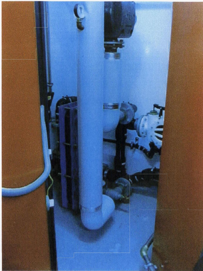
Particolare Scambiatore e filtro acque drenaggio
