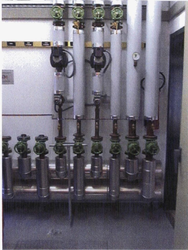
Vista Batteria di distribuzione
