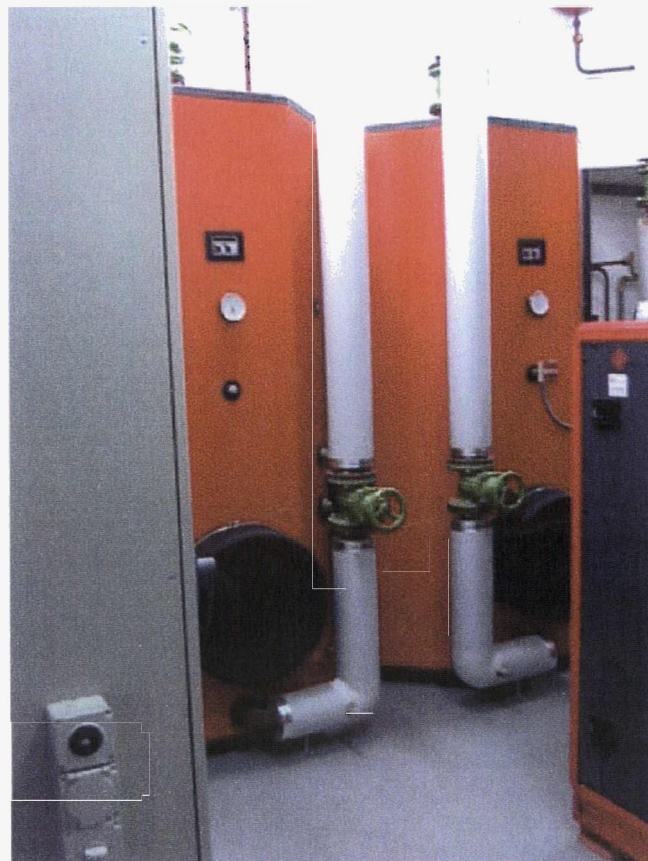
Vista Accumulatori di distribuzione
