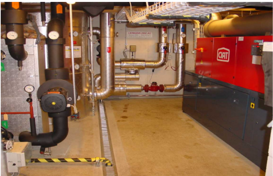
Wärmezentrale mit Wärmepumpe
