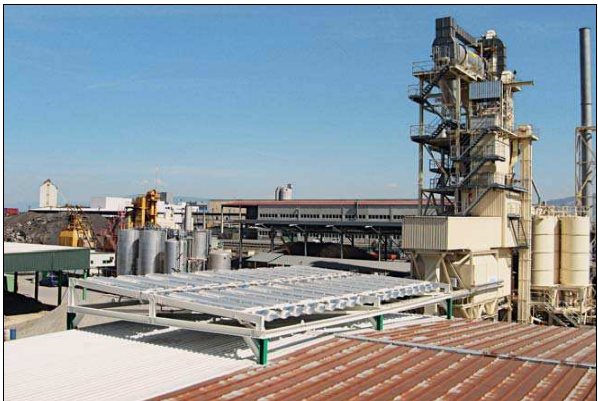
Figure 1 : Champ solaire sur le toit de l'atelier de Colas Genève
