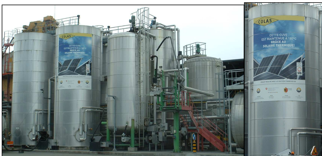
Figure 6 : Cuve de bitume maintenue en chauffe grâce au champ solaire
