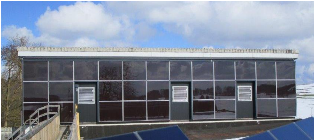
Bild 30: Ansicht der fertigen Anlage (Quelle: Basler & Hofmann AG).
