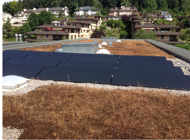
Abbildung 4 – Kollektorenfeld: 4 x 4 Kollektoren (installiert wurden 2 Kollektorenfelder dieser Grösse)
