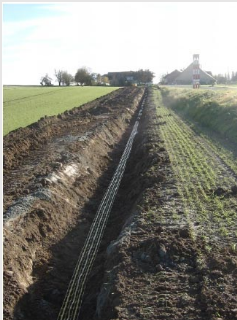
Abbildung 47: Erdverlegte, einfach geführte Gasleitung (5 bar). (Quelle: Cosvegaz)
