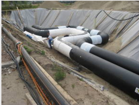
Abbildung 46: Erdverlegte, doppelt geführte Fernwärmeleitung (Quelle: Vattenfall)
