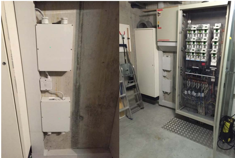
Fig. 48 Hausanschlussschrank bei einer grossen Überbauung
