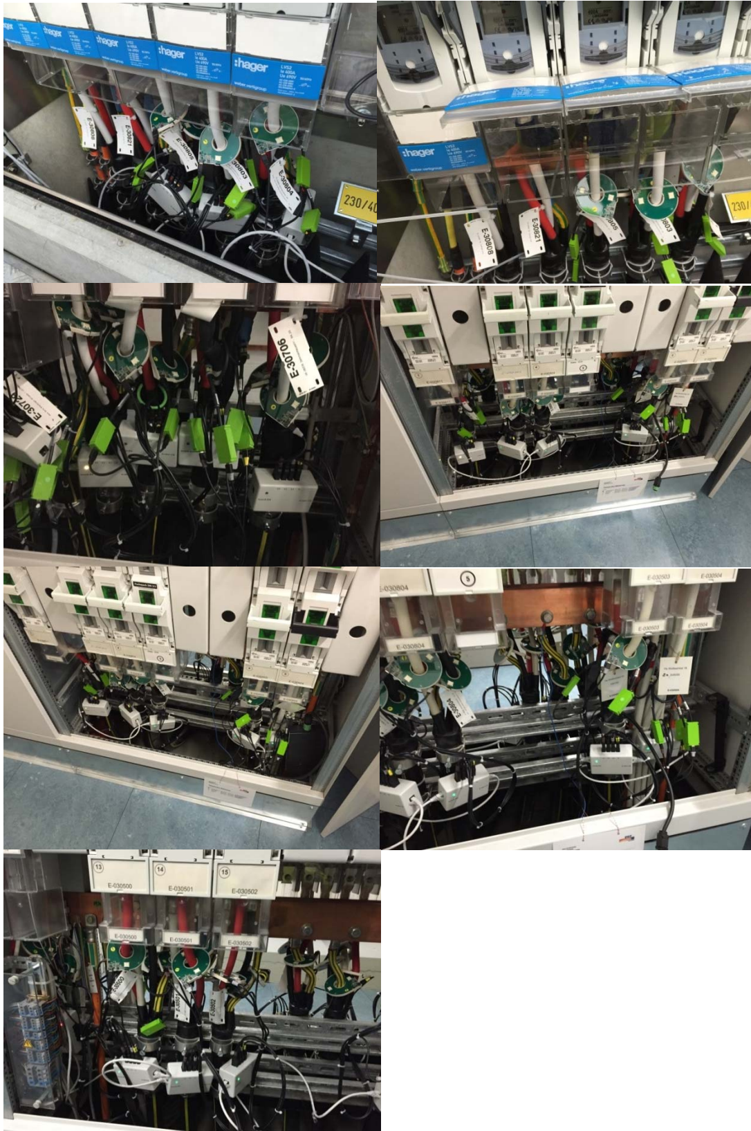
Fig. 44 Messungen der Niederspannungsverteilungen im ewz-Pilotnetz
