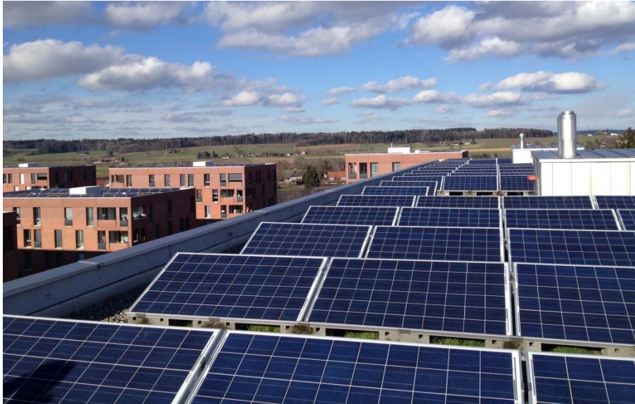
Fig. 36: Beispiel einer PV-Anlage im ewz Pilotnetz
