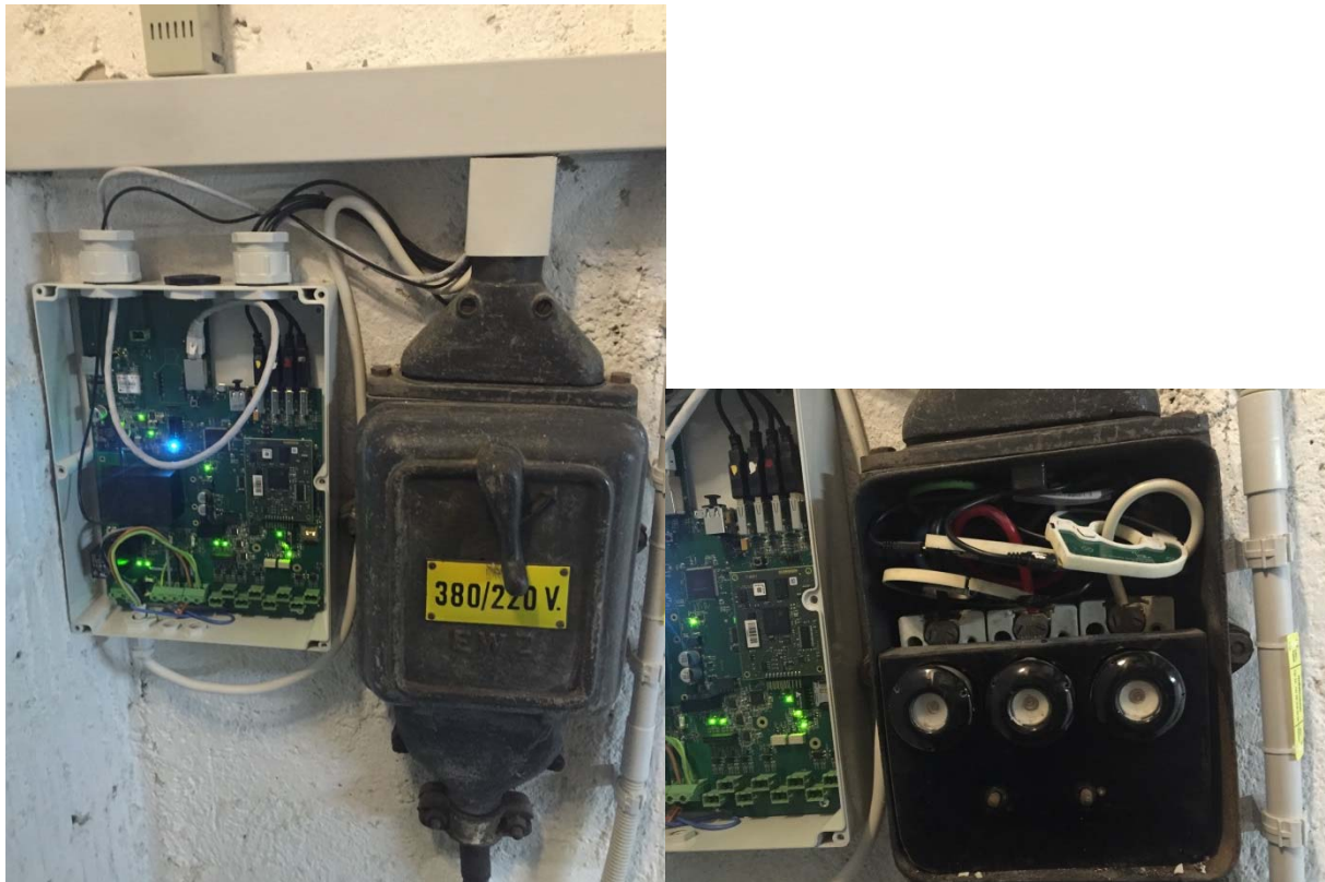
Fig. 47 Alter Hausanschlusskasten (HAK) eines Einfamilienhaus
