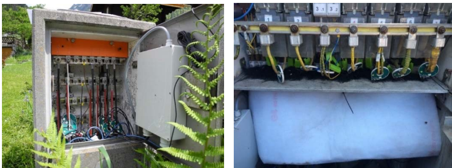
Fig. 27: Kleine VK ohne Sicherungsleisten (links) und mit Hardware unterirdisch (rechts)
