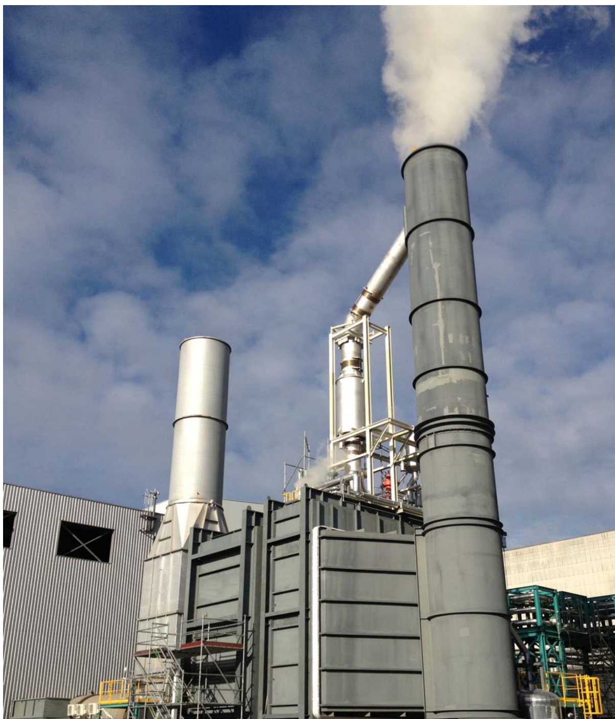
Bild 7: Birr 2 Anlage im Betrieb am 2015-11-06
