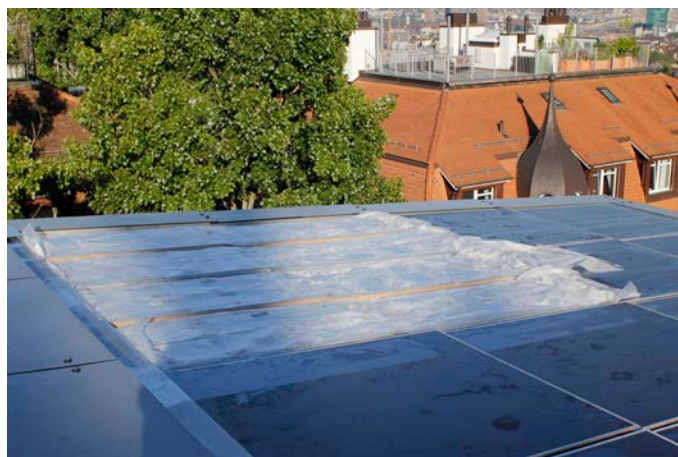
Abb. 21 Stresstest künstliche Bewässerung. Ein Viertel der Anlage wurde frei gelegt und die maximal sorbierbare Wassermenge in Form von Eiswürfeln eingegeben. Auf dem Bild erkennbar ist die Abdeckung der freigelegten Absorber, damit das geschmolzene Wasser nicht verdunstet, sondern von den Dämmplatten langsam aufgenommen werden kann.
