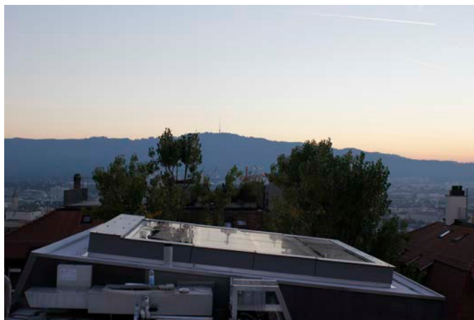
Abb. 10 Fertig installierter Prototyp PT2.
