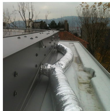
Abb. 13 Zwischenraumkonditionierung. Isolierter Zuluftkanal an Traufseite der Dachkonstruktion.
