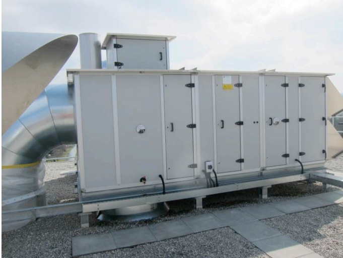
Abbildung 6: Wärmerückgewinnung Motorkühlung, Abluft
