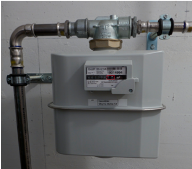
Abbildung 10: Gaszähler Gebäude Stärkeproduktion
