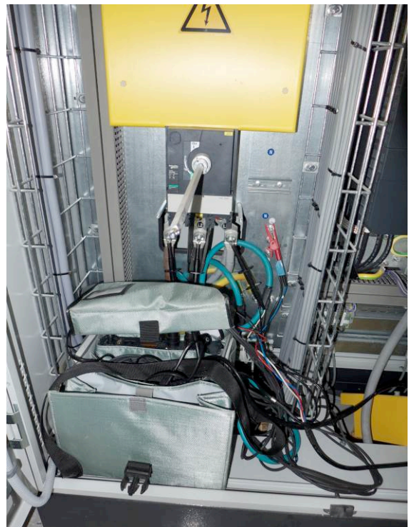
Abbildung 9: Messeinrichtung Schaltschrank C11
