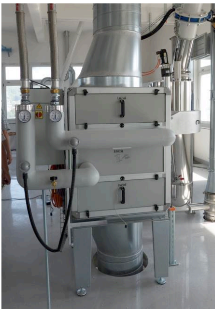
Abbildung 5: Wasser-Luft-Wärmeübertrager für die Sicherstellung der Minimaltemperatur in der Zuluft zum Prozess
