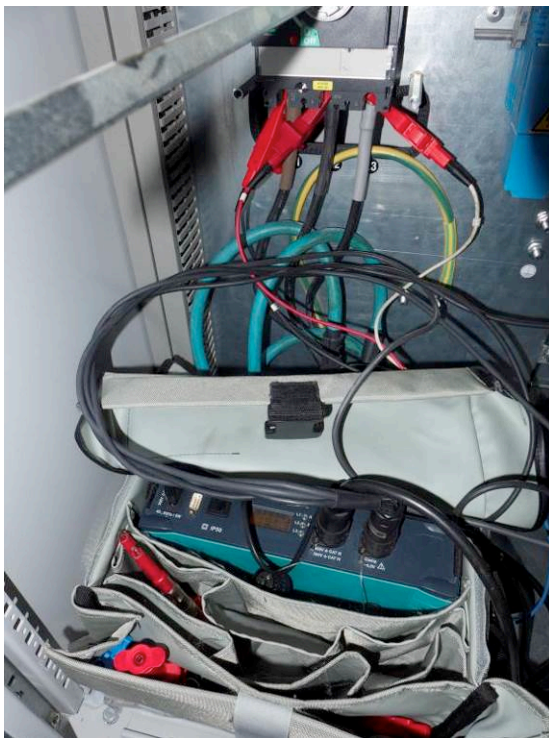
Abbildung 8: Messeinrichtung Schaltschrank C02
