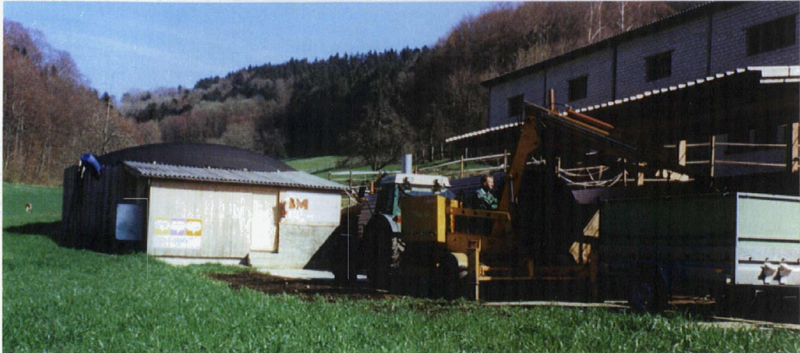
Bild oben: Kompakt-Biogasanlage mit Fermenter, Gasspeicher und Technikraum Im Vordergrund Beladung eines Anhängers mit Fertig- kompost
