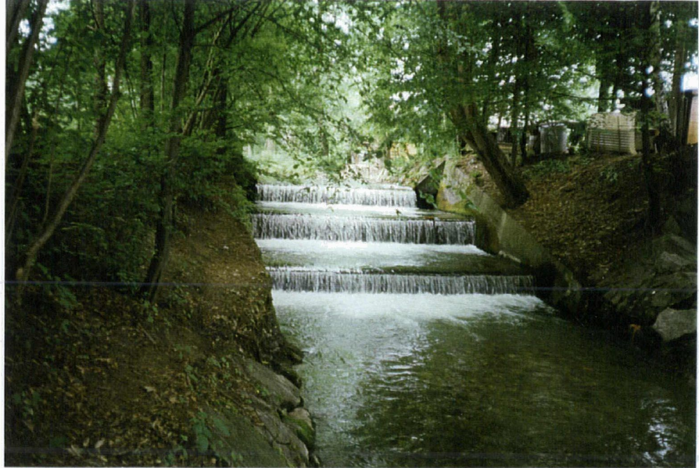
3 Schwellen, 1979 erstellt, behindern die Fischwanderung in der Suhre
