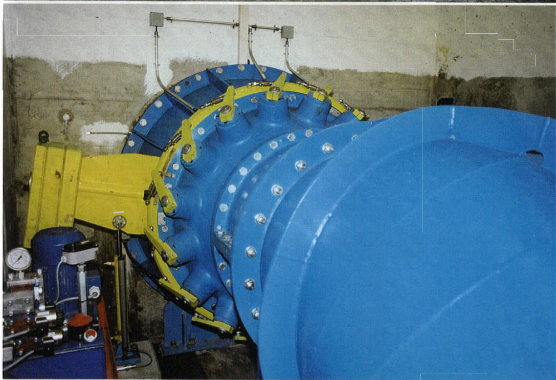
S-Turbine Leitapparat mit Schliessgewicht Ölhydraulik
