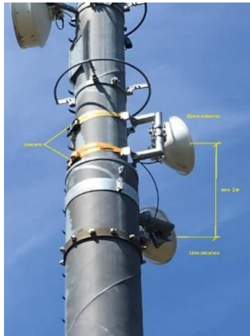
Figure 33 : installation d'une deuxième antenne de mesure
