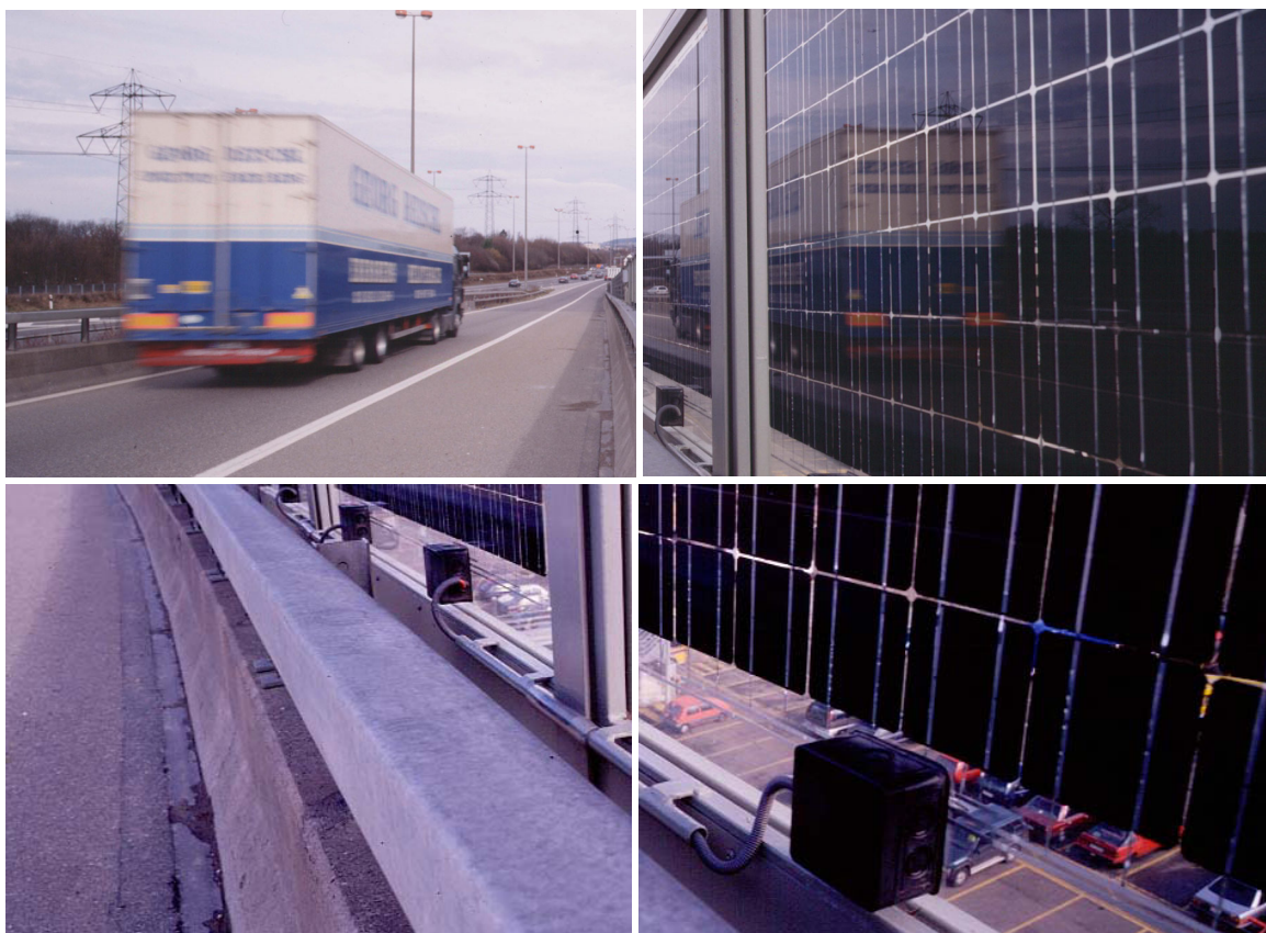
Abb. 9 (2 x 2): Die Bifacial-PV-Anlage im Betrieb
