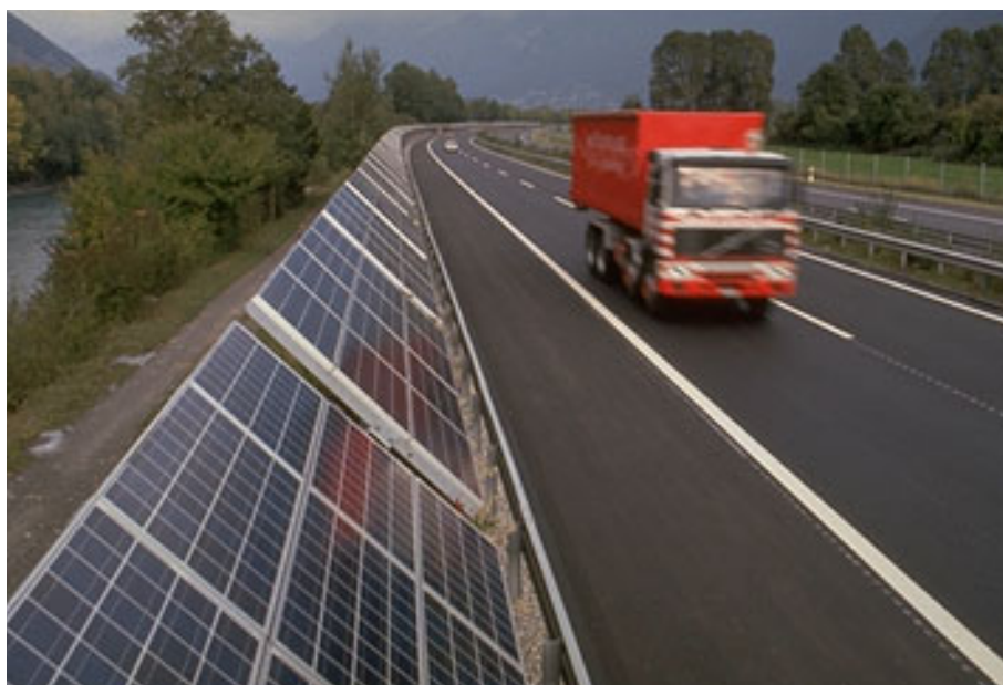
Abb. 1: Die erste PV-Schallschutzwand an der A13 bei Domat/Ems (Standardleistung 100 kW, erbaut 1989)
