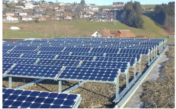
Abbildung 34: Anlage Einsiedeln, Planung: Ars Solaris
