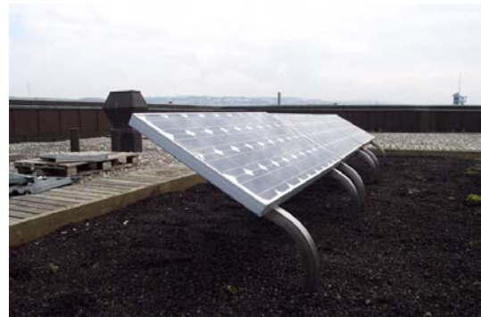
Abbildung 32: fertig installierte Anlage
