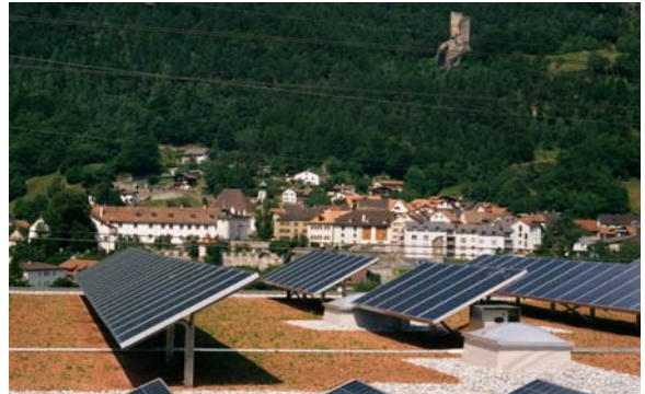
Abbildung 35: Anlage Firma Gasser
