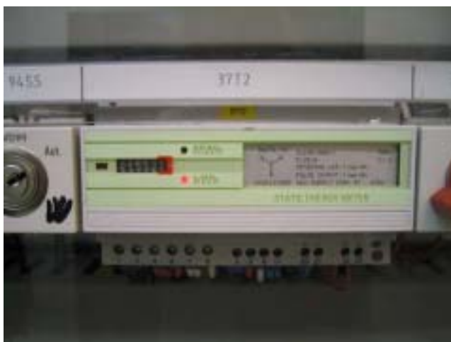
Abb 45: Zähler für PV-Einspeisung
