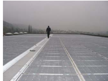
Installierte Anlage Januar 2004
