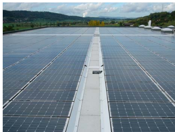
Bild 4: Realisierte Anlage (Sommer 2004)
