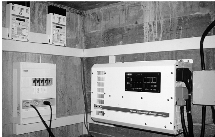
Figure 3 - détail onduleur et tableau électrique
